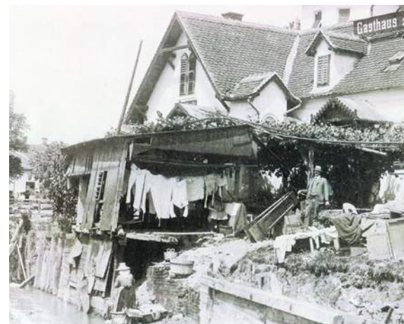
Gebäudeschäden beim Bachwärt bei der Ehlergasse.
